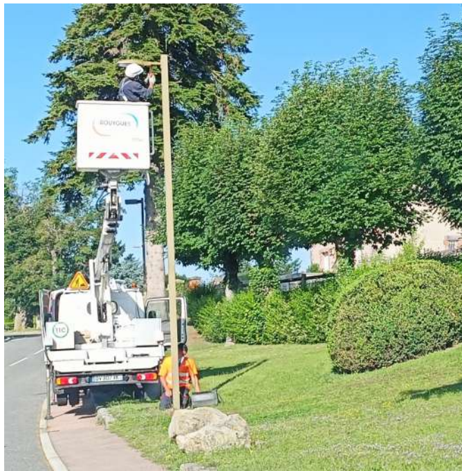
La campagne de remplacement des ampoules éconergivores par des leds continue : intervention avenue Saint Roch, devant l'EHPAD.
