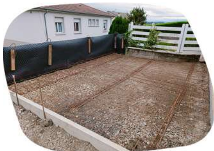
Création d'une dalle pour accueillir des points d'apport volontaire par les services techniques de la ville.
