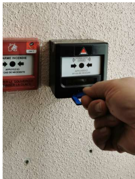
Investissement à l'école publique : mise en place d'un dispositif d'alarme anti-intrusion avec une sonnerie différente de l'alarme incendie.
