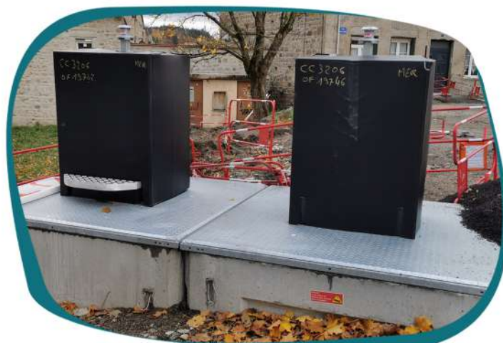
La place des Vallards est également équipée de conteneurs enterrés.
